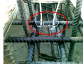
شكل رقم ١٠ - يوضح الشكل الهندسي الذى تم وضعه مع حديد التسليح لتلاشى الموجات الضارة المصدر: الباحث
